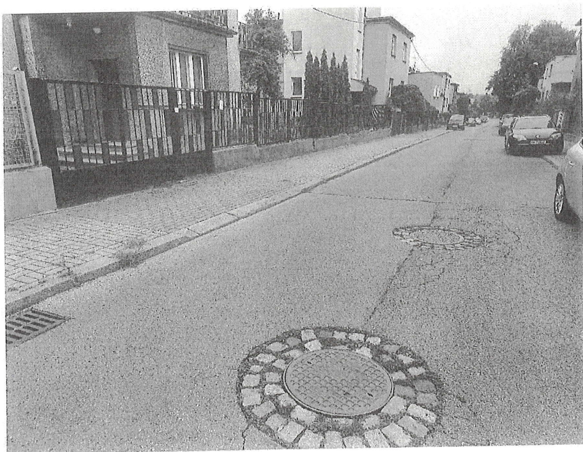
Przy numerze 27 pierścień wjazdu luźny w stosunku do kostki granitowej. Wymiana wjazdu.
